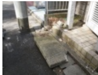
地震でブロック倒壊（大野町）
