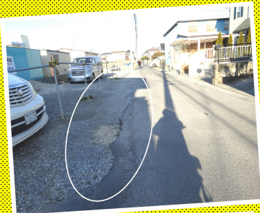
道路舗装が壊れている（宮久保6丁目）
