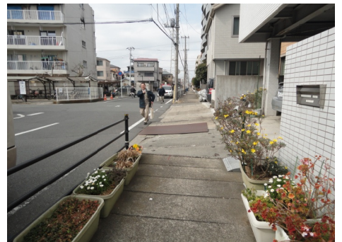
老朽化した蓋かけ歩道の安全対策を予算化(行徳地区)(2月市議会現地調査)
